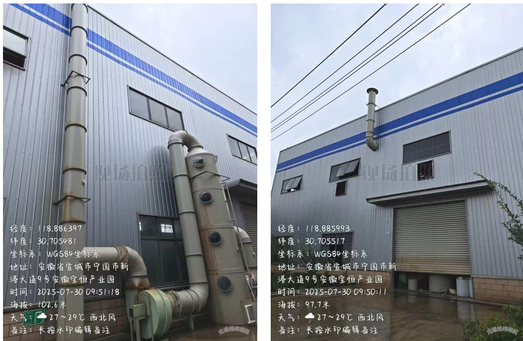
图 6-1 生产线调配、细磨废气排气筒（DA001 左侧 DA002 右侧）
