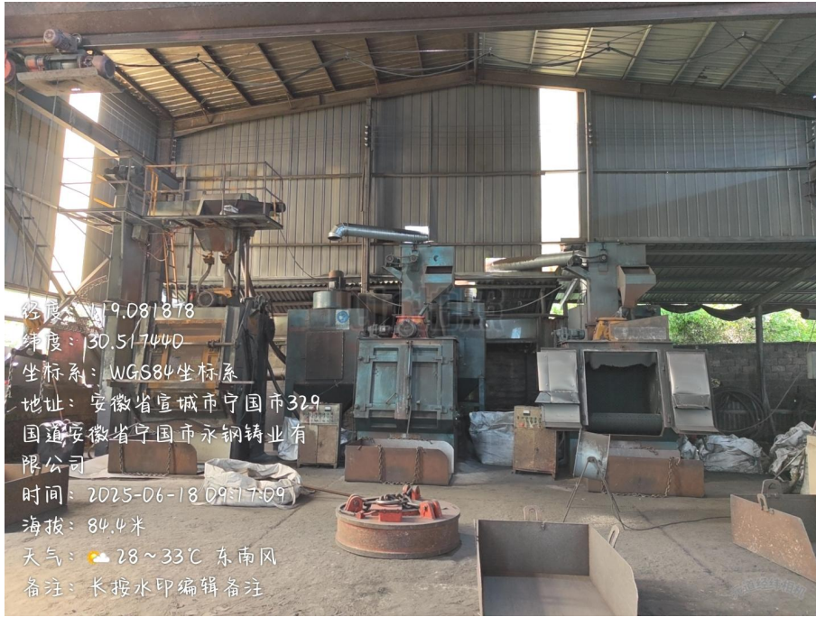
图 6.1-3 抛丸废气处理设施及废气排放口（DA003）
