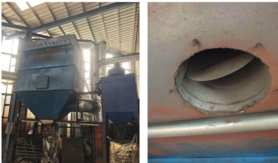
图 6.1-4 抛丸和打磨废气排气筒（DA004）
