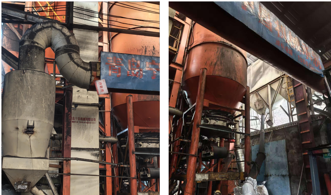
图 6.1-3 铸件车间砂处理废气排气筒 (DA003)
