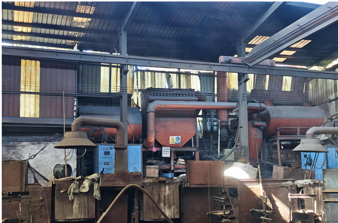
图 6.1-6 钢球车间熔炼废气排气筒（DA006）
