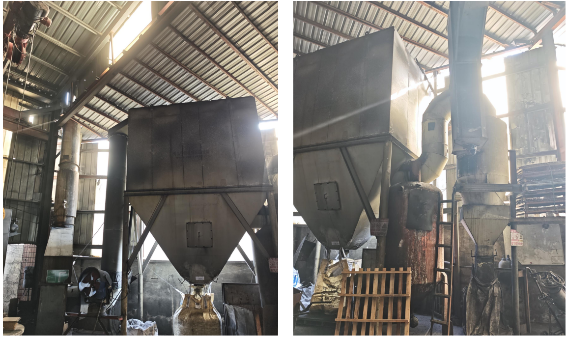
图 6.1-2 落砂废气排气筒 (DA002)
