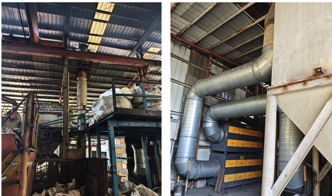
图 6.1-1 铸件车间熔炼、浇注废气排气筒 (DA001)
