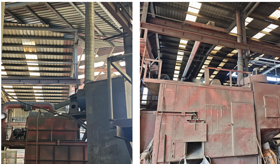
图 6.1-9 钢球车间球锻分离废气排气筒（左：DA009、右：DA0010）
