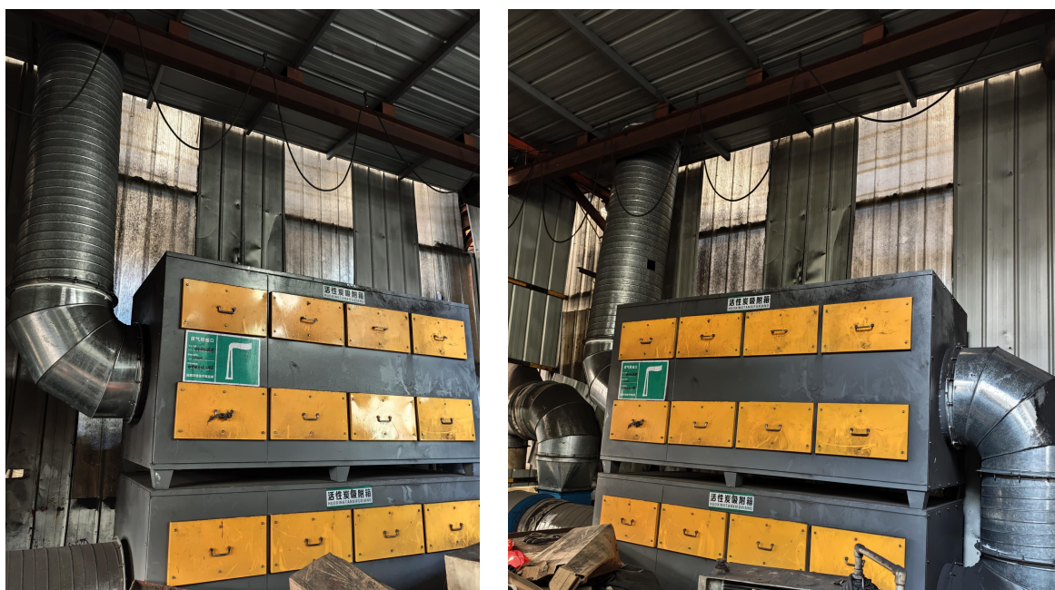
图 6.1-5 浸漆废气排气筒（DA005）
