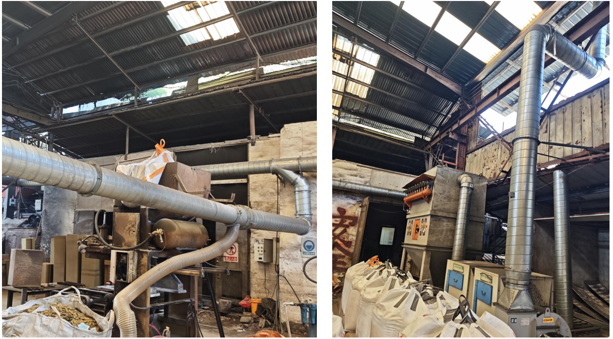
图 6.1-7 浇注、造型和制芯废气排气筒（DA007）
