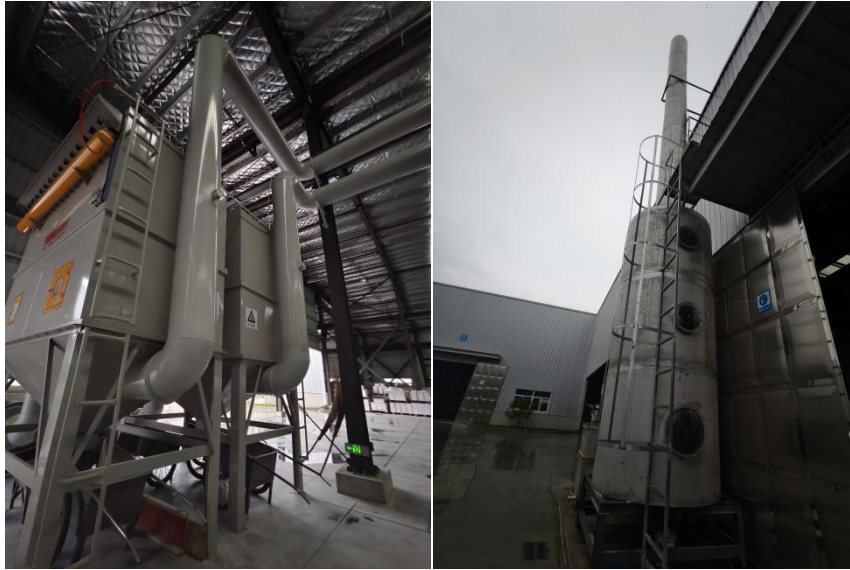
图 6-2 浇注料自动化生产线配料搅拌废气处理设施图
