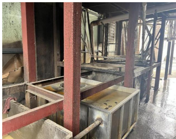
6-3 厂区污水处理设施图
