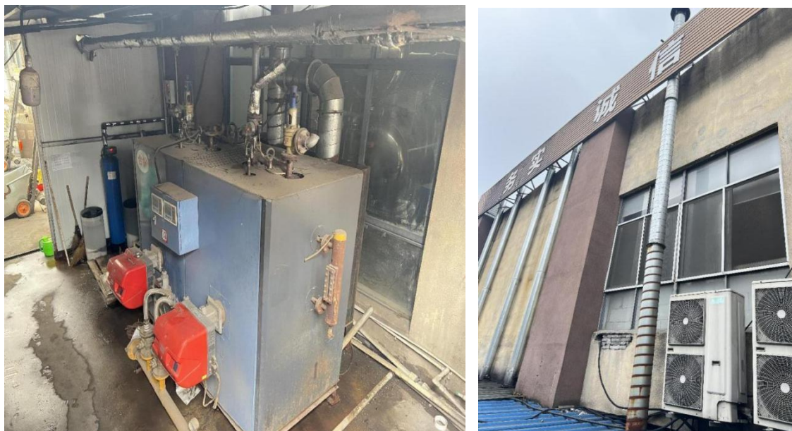
图 6-1 蒸汽发生器燃烧废气排放口
