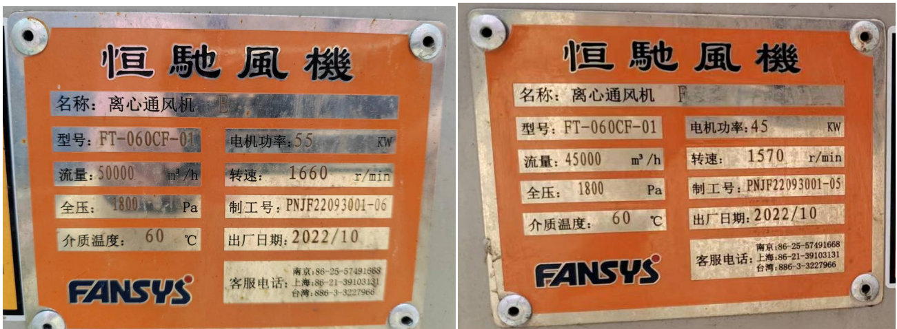
图 4-1 废气处理设施
