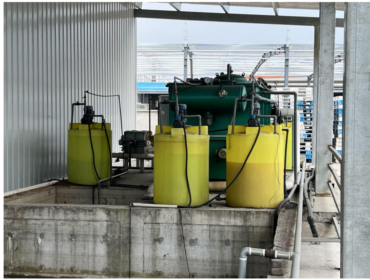
图 6-1 污水处理设施
