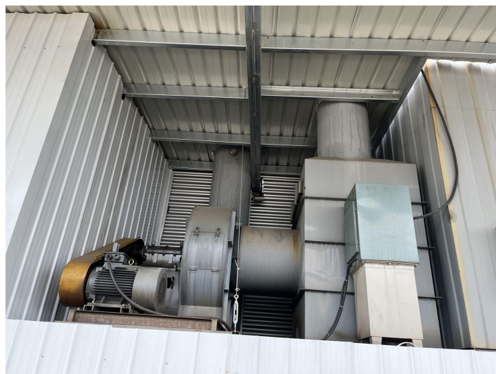
图 6-2 废气处理设施
