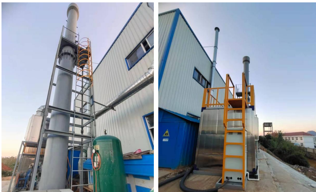
图 6-2 废气处理设施
