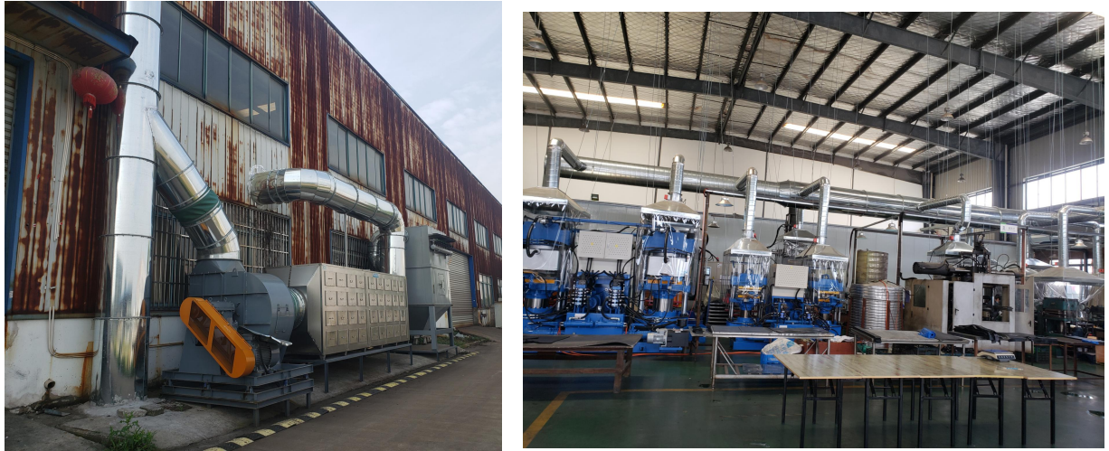
图 4 废气处理设施
